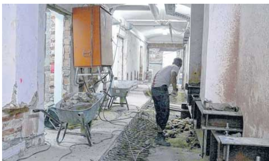
Der untere Bereich des Kulturhauses Böhlen ist eine Baustelle. Der Kellerbereich wird vor Grundwasser geschützt. Foto: Ulrike Wolf
